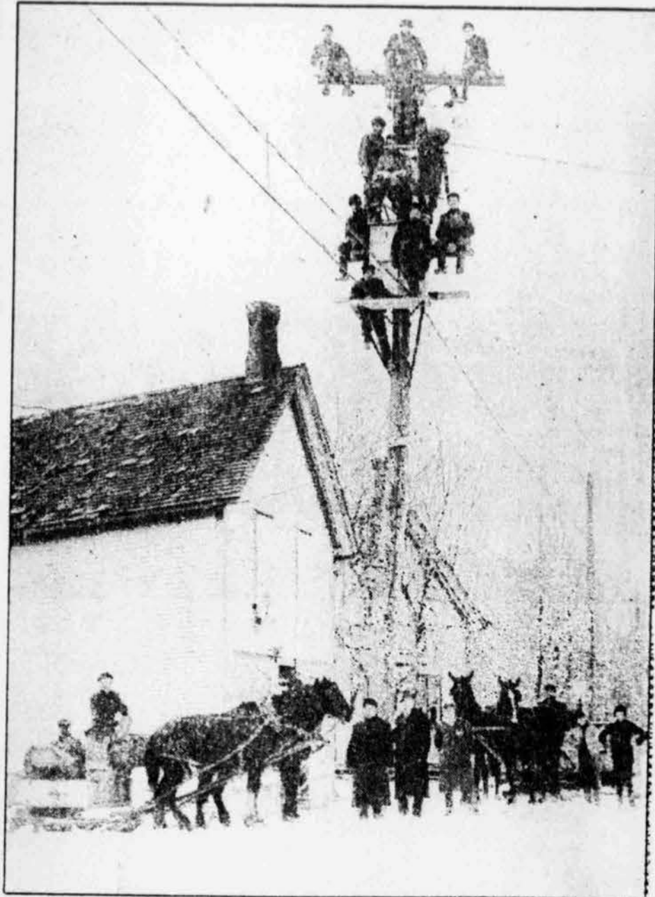
Une équipe d'installateurs — on les appelle aujourd'hui monteurs de lignes — au travail, en 1911.
