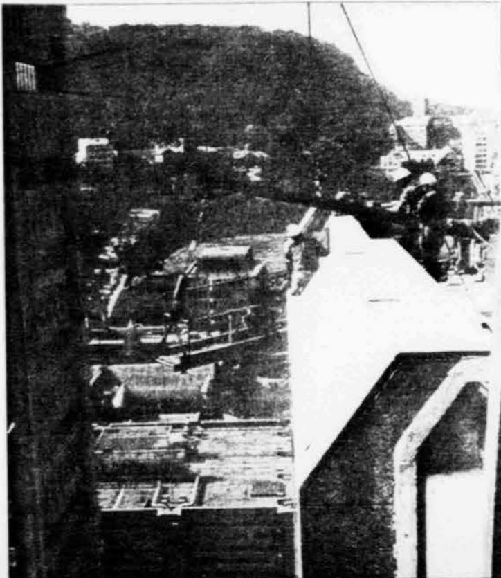
Les ouvriers ont presque terminé l'installation des dalles de granit québécois dont est revêtu l'immeuble de l'Industrielle-Vie, avenue McGill College à Montréal.
