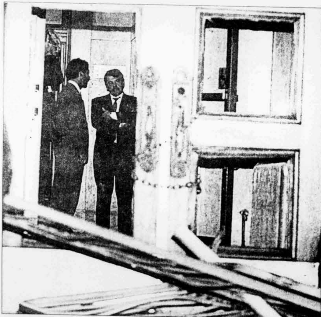
Le maire Doré, accompagné d'un de ses conseillers, inspectait hier soir les dégâts causés aux portes de l'Hôtel de ville par les cols bleus mécontents des offres finales de la Ville. PHOTO JACQUES NADEAU
