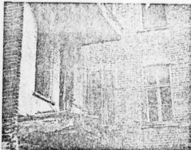
A l'arrière du 748 Agnès, aucune fenêtre n'est barricadée. Les enfants ont fait de ces logements...un terrain de jeux! Leur vie est constamment en danger; tout risque de s'écrouler d'un instant à l'autre. Attendra-t-on qu'un enfant y perde la vie?
