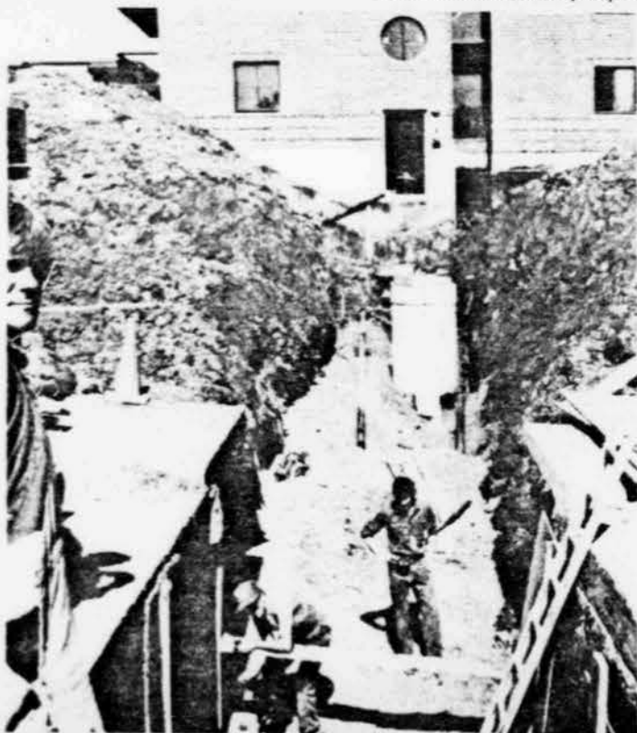
Les travaux se poursuivent à fond de train pour la complétion des travaux à temps pour les premiers déménagements.
