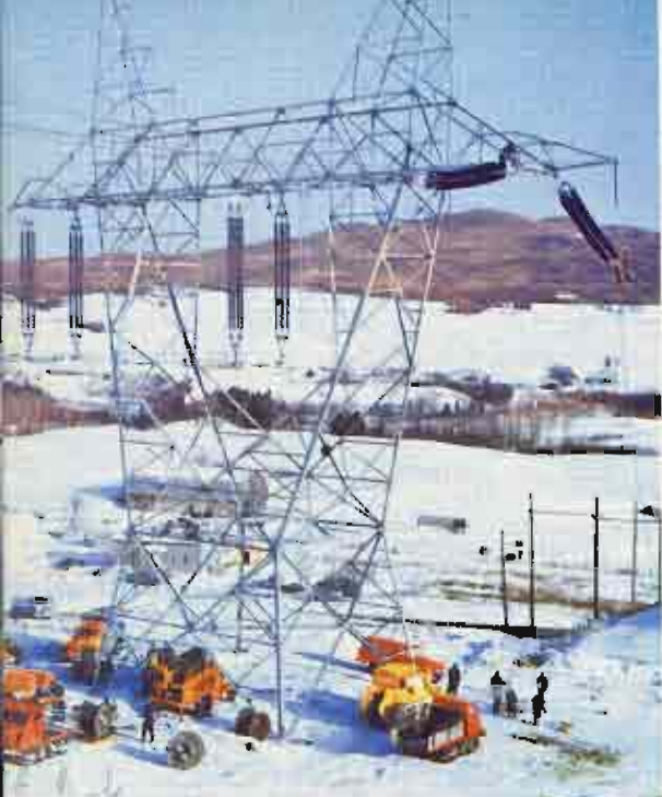
Pylône d'alignement de la ligne à 735 kV dont la construction se poursuit hiver comme été • Suspension tower for the 735 kV line whose construction is carried on year-round • Torre de suspensión de la línea de 735 kV cuya construcción se prosigue todo el año • La Torre di sospensione della linea di 735 kV, in costruzione: I lavori proseguono giorno e notte • Hochspannungsmast für eine Leitung von 735 kV. An dem Bau der Leitung wird Tag und Nacht gearbeitet.
