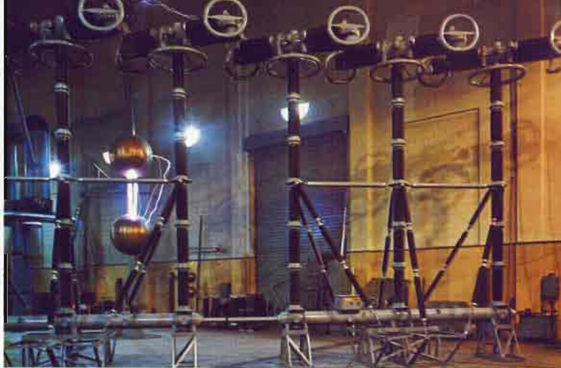
Essai des disjoncteurs réalisé aux laboratoires des usines Delle, à Villeurbanne, en France. Sept pays contribuent à la fabrication de l'appareillage à très haute tension: Suisse, Suède, Belgique, Angleterre, États-Unis, France et Canada • Testing of circuit-breakers in the Delle Company laboratories in Villeurbanne, France. Seven countries are engaged in manufacturing the necessary extra high voltage switchgear: Switzerland, Sweden, Belgium, England, United States, France and Canada • Probando los cortocircuitos en las laboratorios de la Cia. Delle, en Villeurbanne, en Francia. Siete países contribuyen a la fabricación de turbinas de alta tensión: Suiza, Suecia, Bélgica, Inglaterra, Estados Unidos, Francia y Canada • Controllo degli interruttori eseguito nei laboratori delle officine Delle, a Villeurbanne in Francia. 7 paesi sono ingaggiati nella fabbricazione delle apparecchiature ad alta tensione; Svizzera, Svezia, Belgia, Inghilterra, Stati Uniti, Francia e Canada • Prüfung von Leistungsschaltern in den Versuchslaboratorien der Firma Delle in Villeurbanne, Frankreich. Sieben Länder, die Schweiz, Schweden, Belgien, England, die Vereinigten Staaten, Frankreich und Kanada erzeugen die Hochspannungs-Schaltvorrichtungen für die Leitung.
