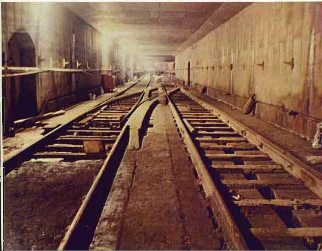
La mise en place des rails est terminée dans une grande partie des tunnels • With track in place, Le Métro is ready to roll • Los rieles han sido colocados en gran parte de los tuneles • Con la messa a punto delle rotaie, la metropolitana è pronta a viaggiare • In den Tunnels sind die Geleise zum grössten Teil bereits gelegt.
