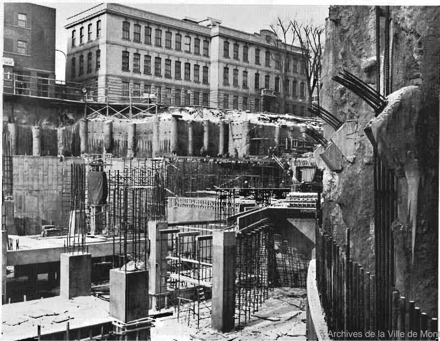
Construction de la station de correspondance Berri-De Montigny où se rencontrent les trois lignes du Métro • Stage of construction at the Berri-De Montigny correspondence station where two lines intersect and a third line begins • Construcción de la estación Berri-De Montigny donde se cruzan las tres líneas del Metro • La costruzione della stazione di corrispondenza Berri-De Montigny, dove si incontrano le tre linee della metropolitana • Bauarbeiten an einer Montrealer Untergrundbahnstation, wo sich drei Linien kreuzen.
