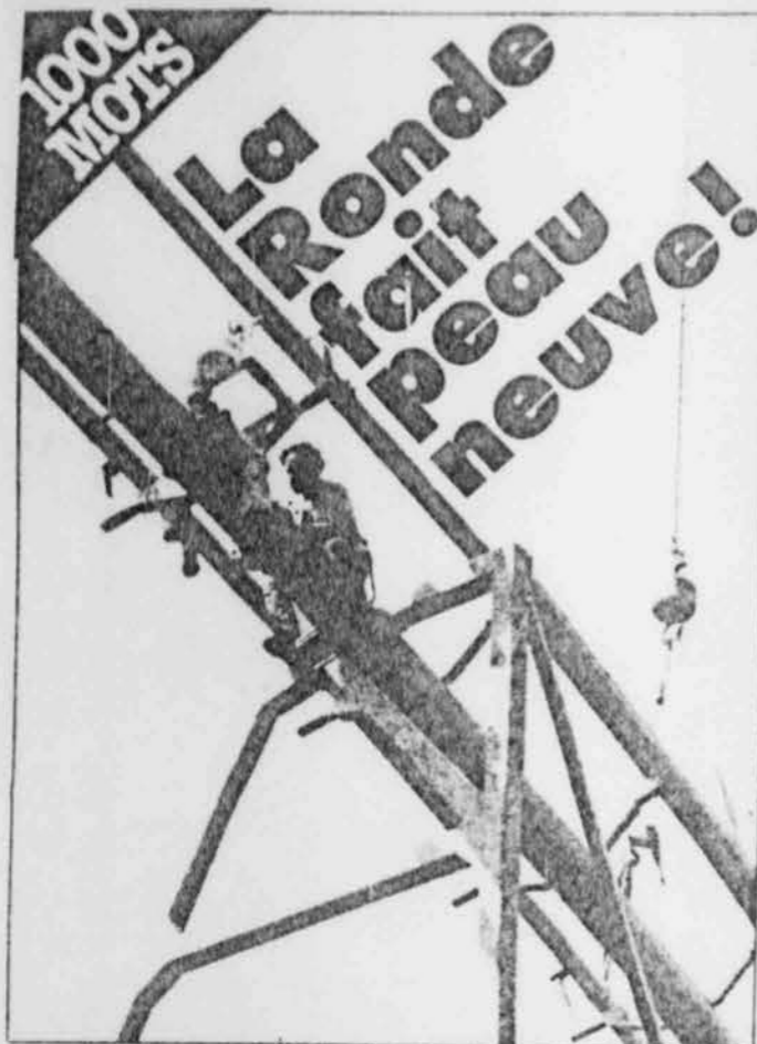
Deux monteurs de structures s'affairent à assembler une section du Supermanège à l'aide de gros boulons.
