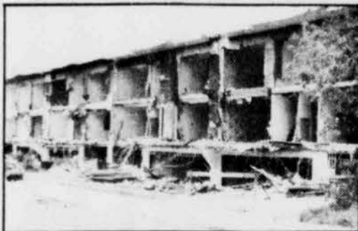
Depuis samedi dernier, la démolition des maisons va bon train sur la rue Sylvestre.
