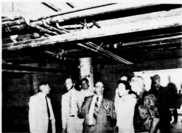
Le conseiller municipal de Rosemont Jean Trottier n'a pas manqué de visiter en compagnie des ingénieurs et architectes l'état actuel des travaux des résidences Alleluia.
