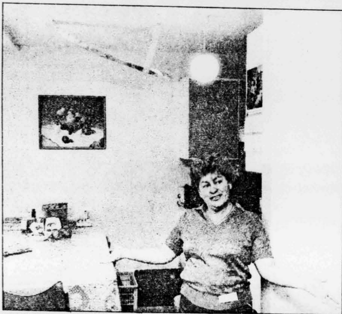
Mme Leila Ramos a inventé cette gouttière, au plafond, pour détourner l'eau qui autrement tomberait sur la table.
