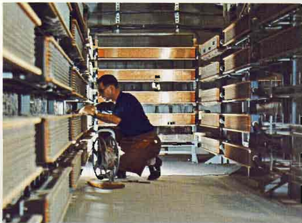
Centre nerveux des communications téléphoniques du plus important building de Montréal ● Communications centre in Montreal skyscraper Place Ville Marie ● Central telefónica del rascacielos de Place Ville Marie, de Montreal ● Il centralina telefonico del grattacielo di piazza Ville Marie ● Telephonzentrale in Montreals "Place Ville-Marie" — Wolkenkratzer.
