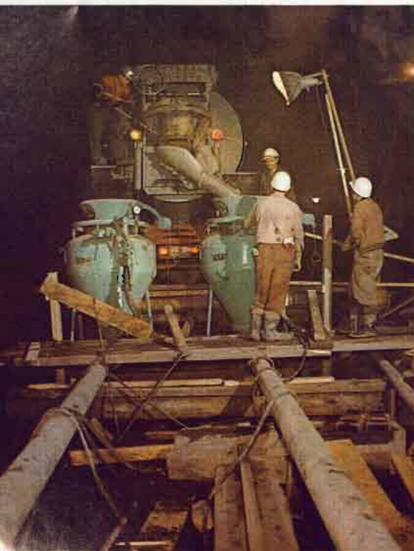
Une bétonnière dans l'un des tunnels du métro • Under lights, subway workers race against deadline • En los túneles del Metropolitano se trabaja día y noche • Si lavoro di giorno e di notte, alla luce dei riflettori • Eine Betonmischmaschine in einem der U-Bahn-Tunnels.
