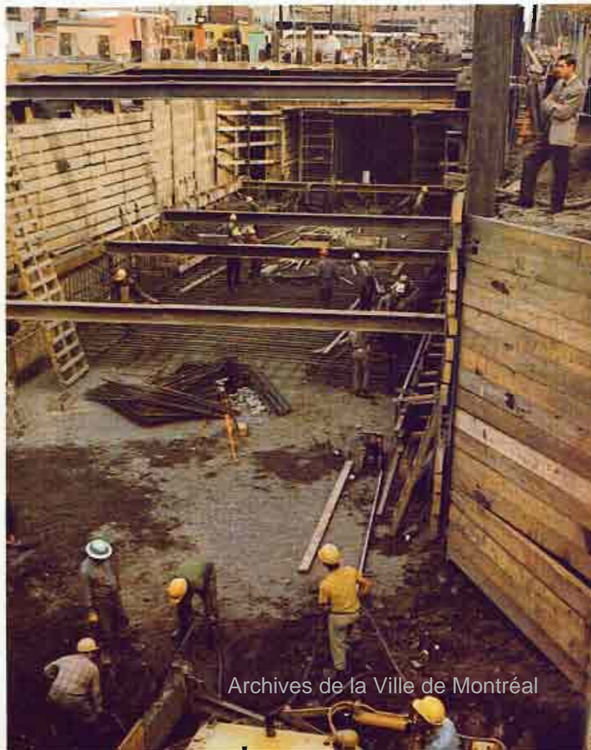
La station Berri, point de correspondance, a nécessité des travaux considérables, sur trois paliers différents • From sidewalk level, vast scope of work is clearly illustrated • La estación central "Berri" ha requerido trabajos considerables • I tre piani sotterranei della stazione centrale • Bauarbeiten an der U-Bahnstation Berri, einem wichtigen Knotenpunkt im neuen U-Bahnnetz.
